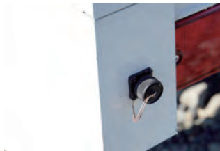
外部電源接続端子がセットされています
