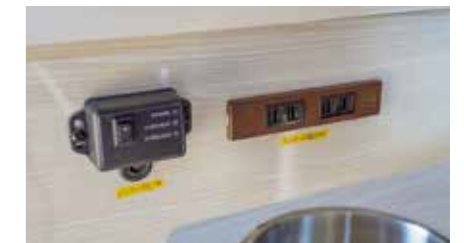
インバーターのリモコンスイッチと100Vコンセント
